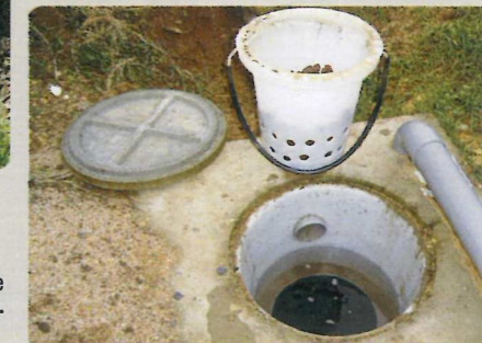
Préfiltre de la fosse toutes eaux.
