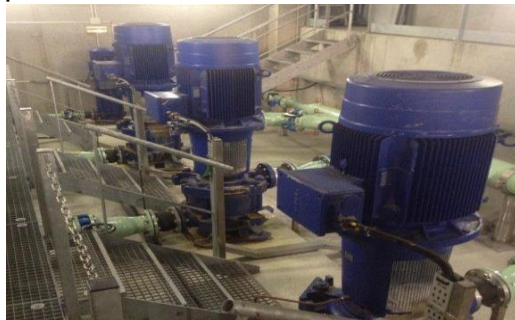
Pompes de surface projetées
