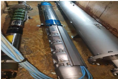
Pompes actuelles dans les bâches
