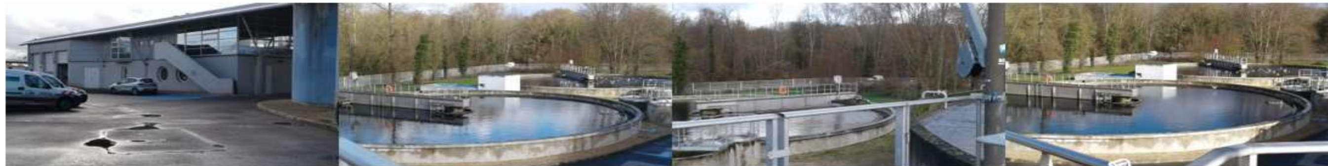
Station de traitement des eaux usées « Nemosa » de Nemours
