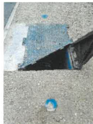
Chambre du débitmètre de la route du Bourdonnois à Bagneaux
