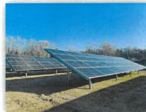
Panneaux solaires - Nemosia
