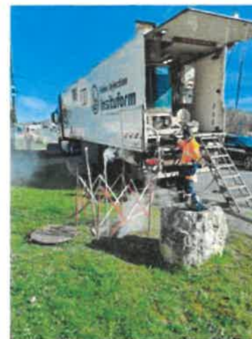
Polymérisation à la vapeur d'eau chauffée à 120°C de la gaine, suivi d'une heure de refroidissement
