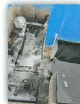
Eau traitée – rejetée vers dans le Loing
