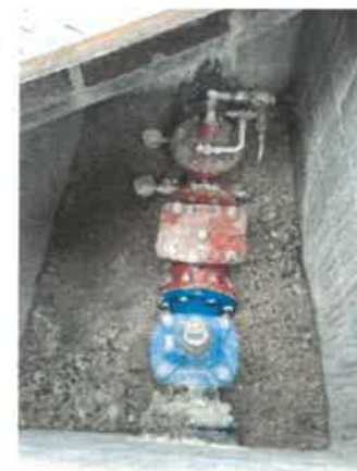
Stabilisateur aval, route de Montargis à Nemours
